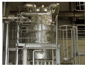
海水淡水化実験装置
